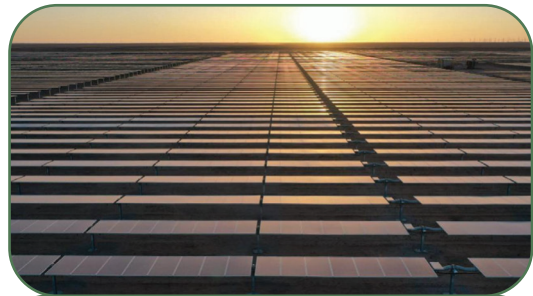
محطة سكاكا المستقل للطاقاة الكهروضوئية
